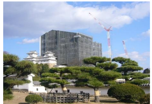
鉄骨で組立てた工事用素屋根 見学用エレベーター付き
